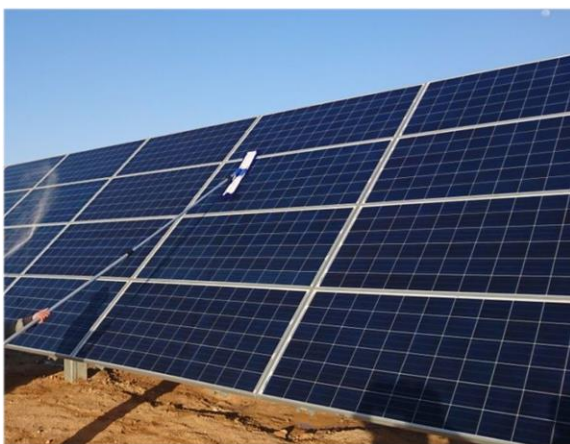
Figura 1: Representação de um exemplo de limpeza manual de módulos solares. Fonte: www.sintef.no
