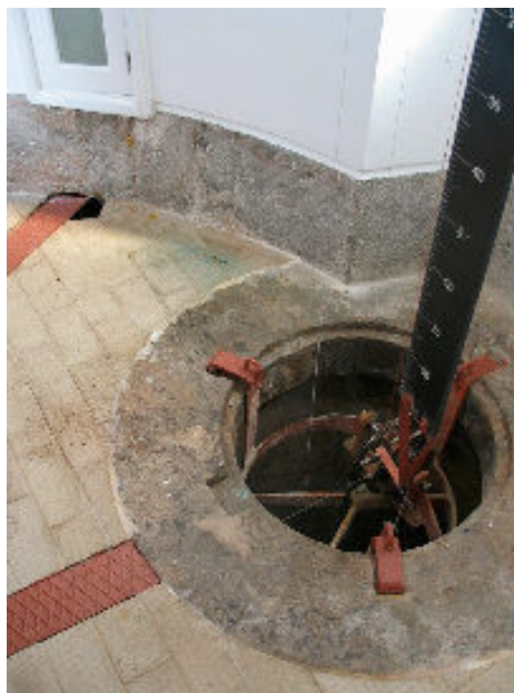
Imagem 4 Poço onde flutua a bóia
