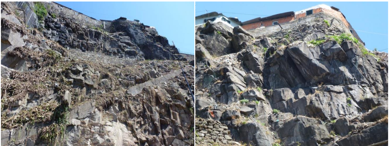
Figura 7 - Setor 5. Estado da escarpa antes das obras de estabilização
