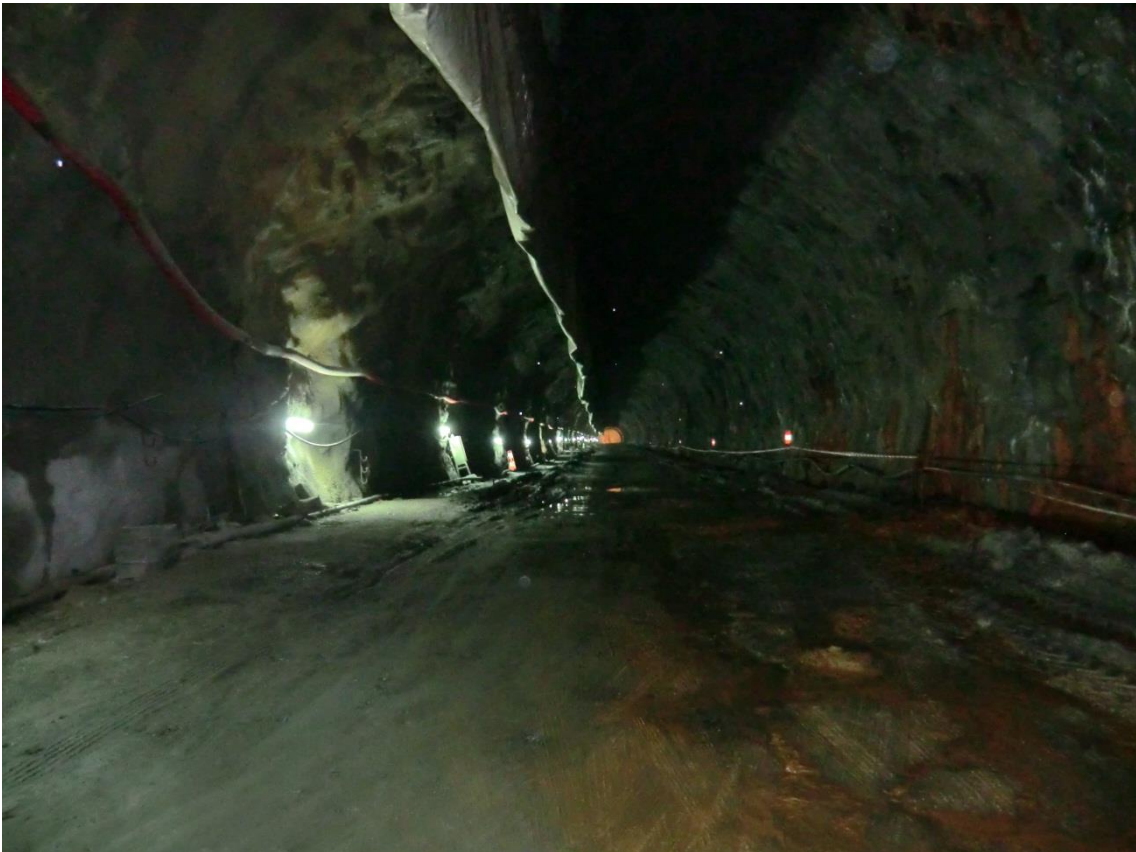
Figura 4 – Interior da galeria sul poente observando-se no hastear direito algumas das patologias decorrentes da paragem dos trabalhos
