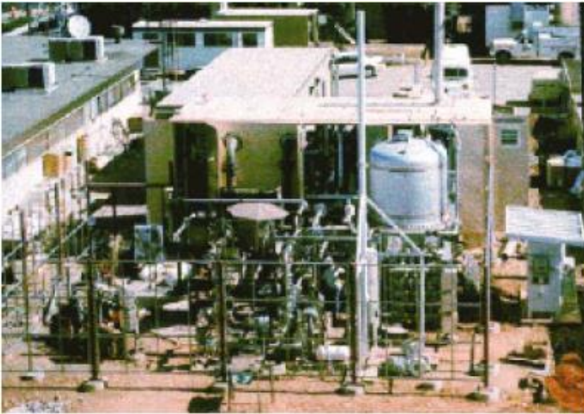
Central eléctrica à base de MCFC com 250 kW, 1997.
